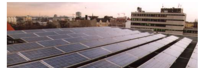
Photovoltaikanlage Forum Kreuzberg
